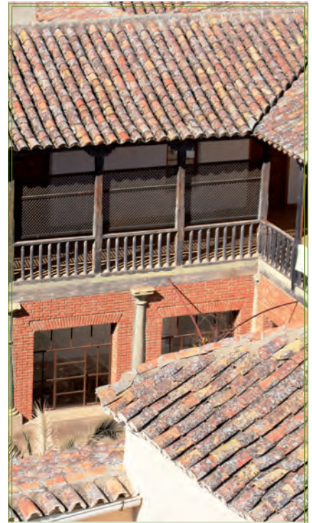
He aquí las entrañas del Monasterio de San José, donde viven nuestras queridas monjas dominicas. Lo que vemos es parte del coro exterior del centenario convento, con sus columnas y balaustrada de madera rodeando las celdas de la clausura.
